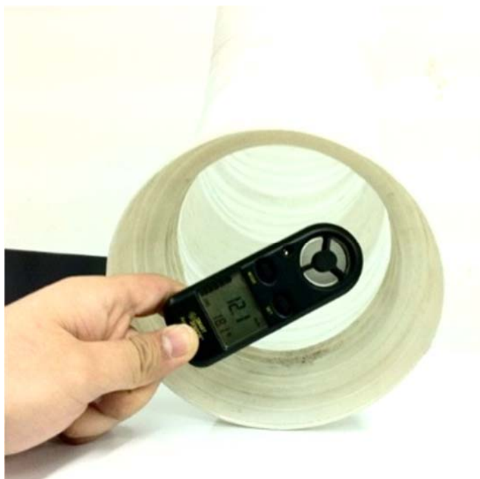
照片二：排风口风速
