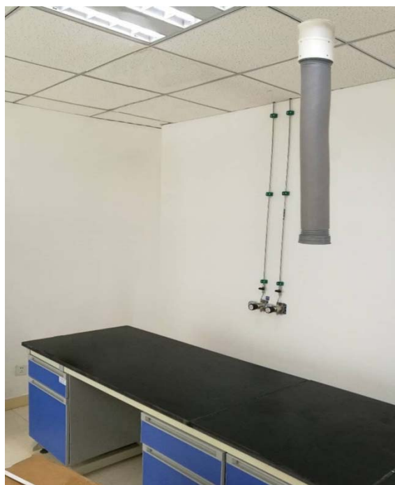
照片一：实验台+排风管道+伸缩软管
